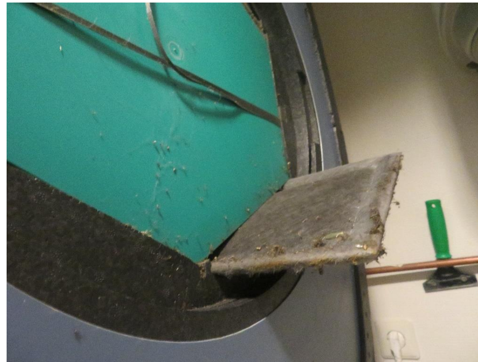
Filters installatie op tijd vervangen
