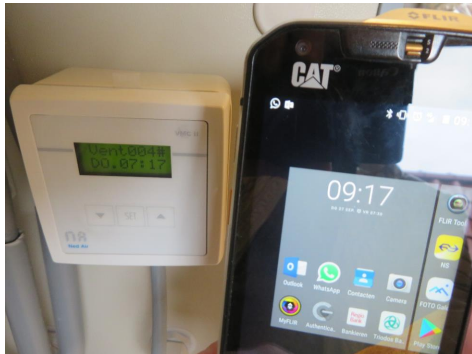
tijdklok ventilatie loopt 2 uur achter
